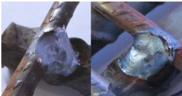
▲ Mordedura - Defeito de maior gravidade deve ser eliminado ou controlado.
