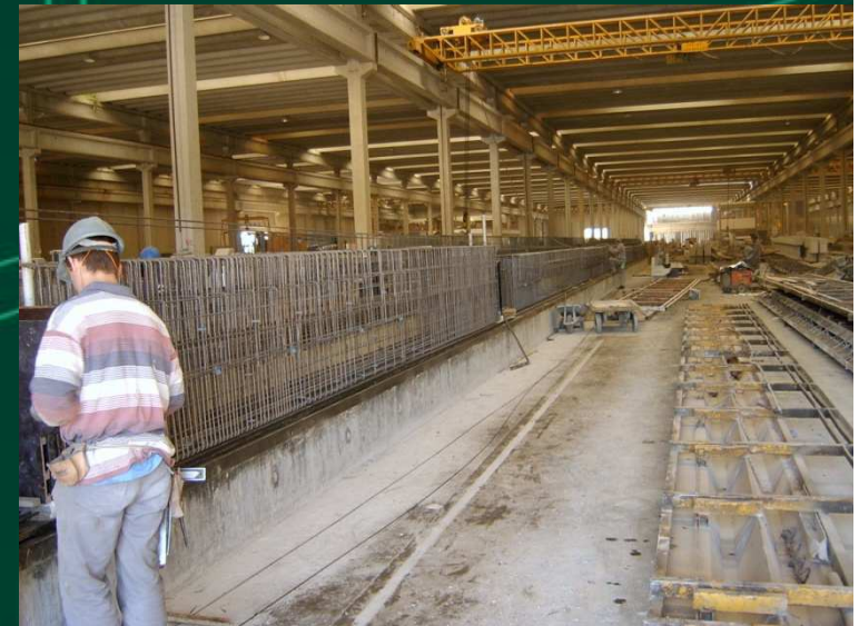
Armadura Frouxa. Armadura Protendida.
