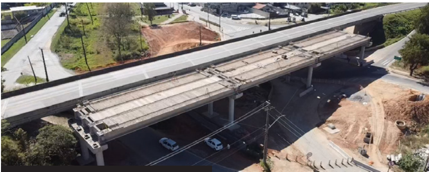
Pré-fabricação de concreto tem sido primordial para a realização das obras de duplicação da Raposo Tavares, entre os municípios de São Roque, Mairinque e Alumínio
